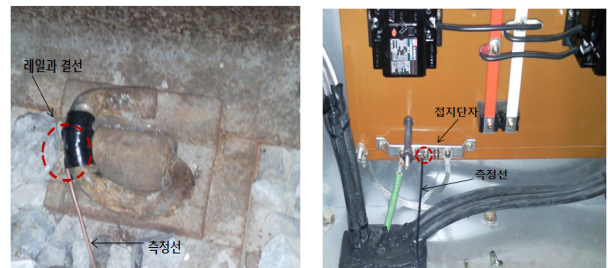
그림 2 레일과 측정선 결선(좌), 스크린도어 접지 단자와 측정선 결선(우)
