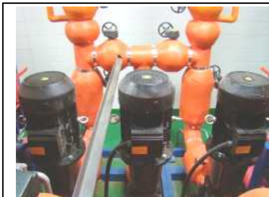
<고효율 펌프 및 대수분할 제어>
