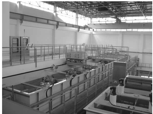
K²IMAS 실증플랜트 전경 (대전수자원공사)
