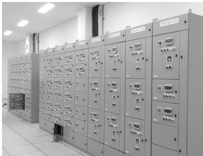
[현장 MCC에 설치된 모습]
