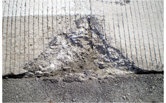
(b) 우각부 파손 부위
