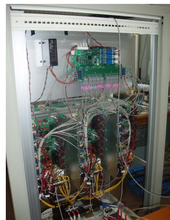
그림 8 멀티레벨 인버터 사진 Fig. 8 Photograph of multilevel inverter
