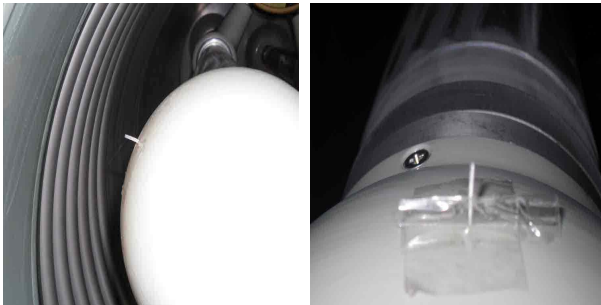
그림 10. GIB 내부에 설치된 결함 사진 Fig. 10. Pictures of installed defect inside GIB
