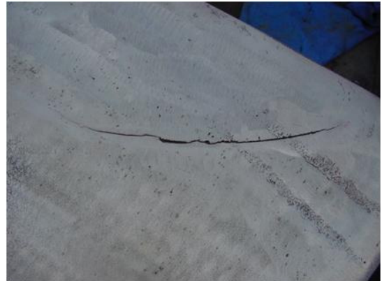
그림 9: 부적절한 용접보수부의 균열
