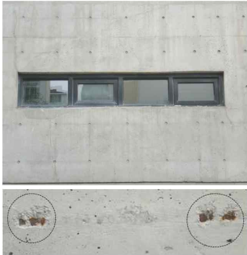
그림 15. 노출콘크리트의 피복두께 부족에 의한 철근 부식 상황
