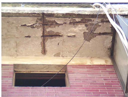
그림 16. 공동주택 발코니 하부의 철근 부식 상황
