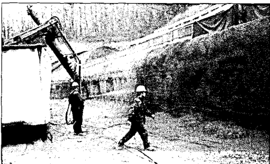
그림 6. 숏크리트 타설시 숏크리트 탈락 발생
