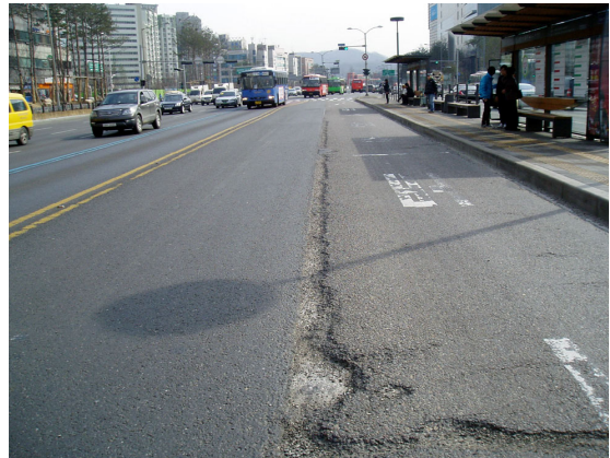
사진 1. 시공조인트 부분 동해 손상
