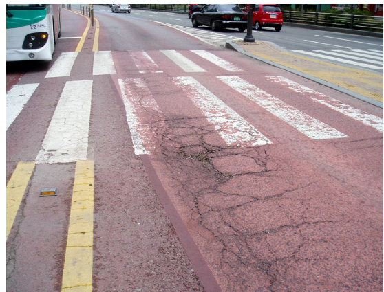
사진 2. 지지력 부족에 의한 침하균열 손상
