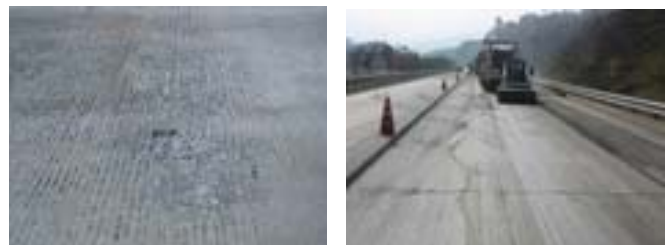
(a) 기존 콘크리트 포장 손상면
