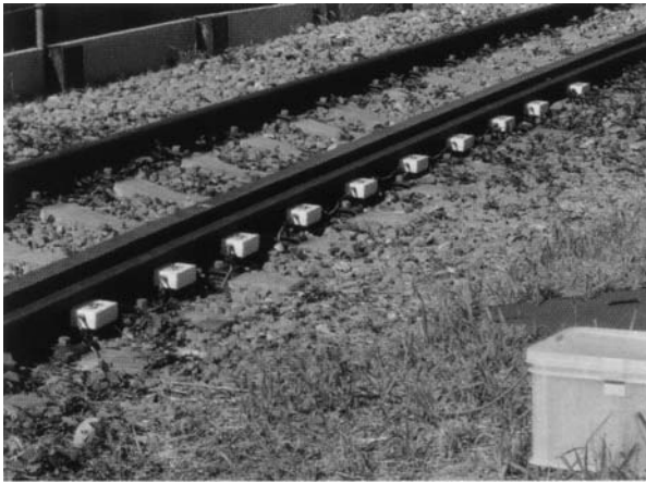
그림 7. 무선 센서 유닛을 이용한 궤도변위 감시시스템의 예
