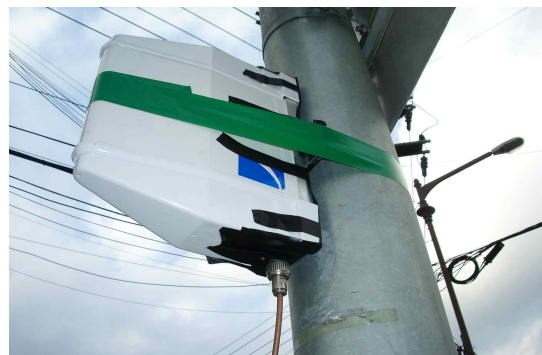
그림 2. 횡단보도에서 보행자 신호등에 RFID 리더 안테나 설치 Fig. 2. The installation of RFID Reader ANT on a traffic sign light pole.
