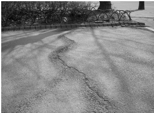
〈사진 1〉 가로수 나무뿌리에 의한 파손
