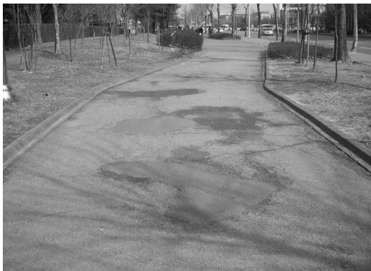
〈사진 2〉 재료의 내구성 및 품질관리 관련 파손
