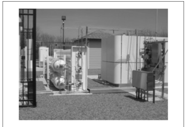
Fig. 5 수소, CNG, HCNG충전소 전경(Hempstead in New York)
