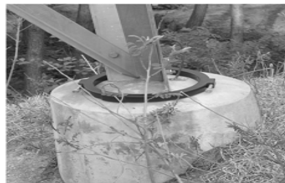
그림 7. 탐각 취부용 Split-core 변압기. Fig. 7. Split-core transformer for tower footing leakage current measurement.
