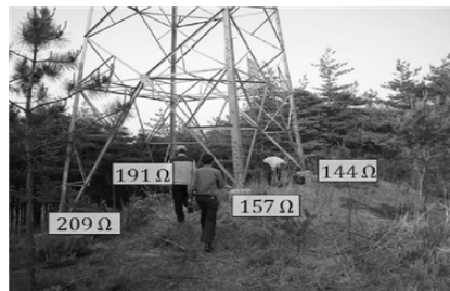
그림 8. 개별 탐각의 저항 측정. Fig. 8. Individual resistance of 4 footings.
