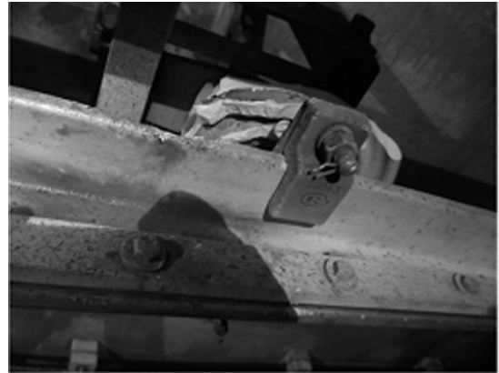
그림 2. 아크로 인한 애자 파손 및 T-bar 손상
