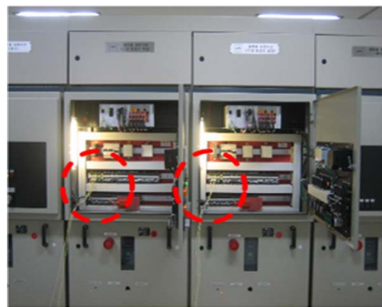
그림 7 급전선의 전압, 전류 계측지점 Fig. 7 Measurement point of voltage and current at positive feeder
