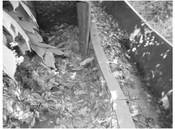
그림 18. 기성품 시공으로 배수로 들뜸(배수 안됨)
