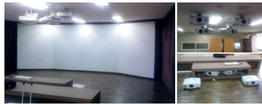
<그림 3> 실제 설치한 스크린 (a) 과 8개의 프로젝터들 (b)
