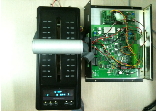
그림 10. Engine Control Room 속도전달장치 상태 Fig. 10 Engine Control Room Telegraph Lever Control Unit Status
