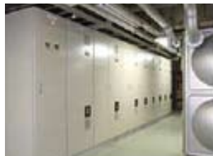
펌프 변류량 제어 인버터 제어반
