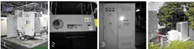
1. 고효율 냉온수 발생기 2. 주차장 고효율 환기 시스템 유인팬 3. 송풍기 인버터 설비 4. 고효율 코제네레이션 설비
