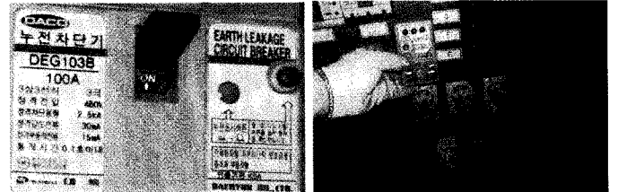
〈사진 6〉 누전차단기 동작상태 점검
