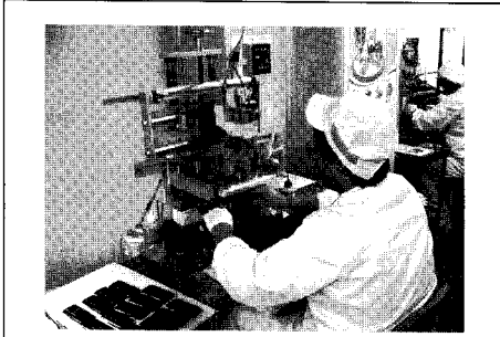
수동 인쇄공정에 국소배기장치가 설치되어 있지 않아 근로자에게 유기화합물질 그대로 노출되고 있는 상태임
