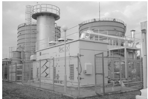
▲ 포스코파워가 설치한 250Kw급 MCFC형 연료전지
