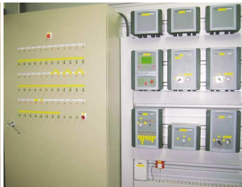
인공지능환기 시스템 콘트롤러 설치 사진
