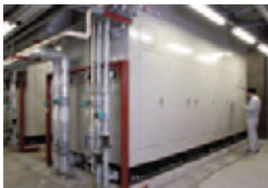
코제네레이션(cogeneration) 설비 외관
