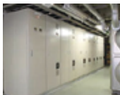
펌프 변류량 제어 인버터 제어반
