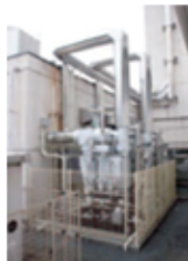
배기가스 증기 보일러 설비 외관
