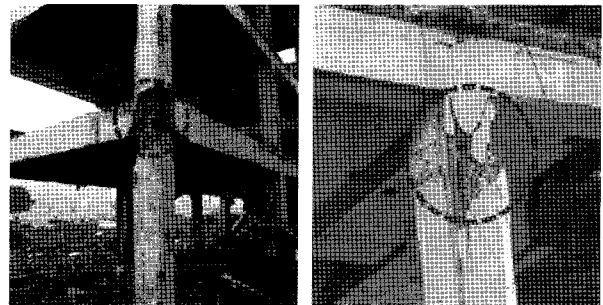
(a) 1층 상부패널 파괴 (b) 2층 기둥상부 파괴
