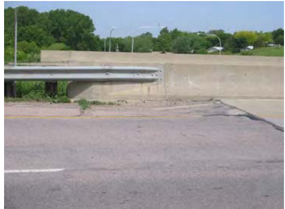
그림 1. 전형적인 교대 접속부에서의 단차발생 예
