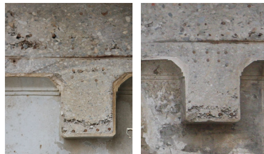
사진 2. 보단면에 나타난 콘크리트의 다짐불량
