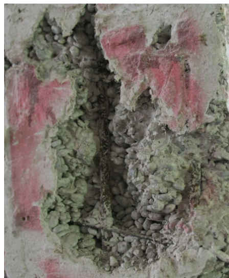
사진 3. 1층 기둥 하부의 재료분리
