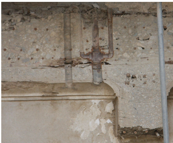
사진 4. 철근콘크리트 슬래브 속의 설비배관 흔적
