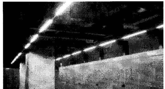
그림 7 변전실에 설치된 조명등기구의 실제사진 Fig. 7 Stereoscopic photograph of lighting fixtures established to substation
