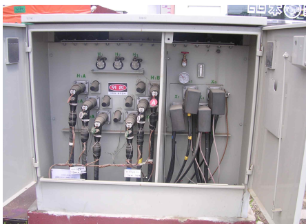
그림 2 패드 변압기 설치 현장(3상 300kVA) Fig. 2 Installation site of Pad Tr (3Φ300kVA)
