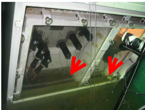
그림 8 변압기 내부와 외부의 침수 높이 차이 Fig. 8 Flooded level difference of transformer Internal and external
