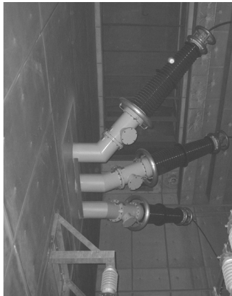
〈그림 13〉 154kV 변전소의 절연애자 형상
