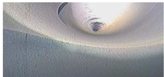
그림 32 급수 배관 내부의 점검 모습 Fig. 32 The check diagram of feed pipe inner part
