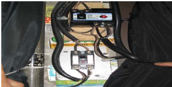
그림 1 재래시장 차단기 설치 상태 Fig. 1 Breaker situation at conventional markets
