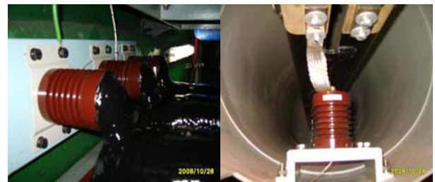
그림 3 Ceramic Coupler 센서 설치 Fig. 3 Installation of Ceramic Coupler Sensor
