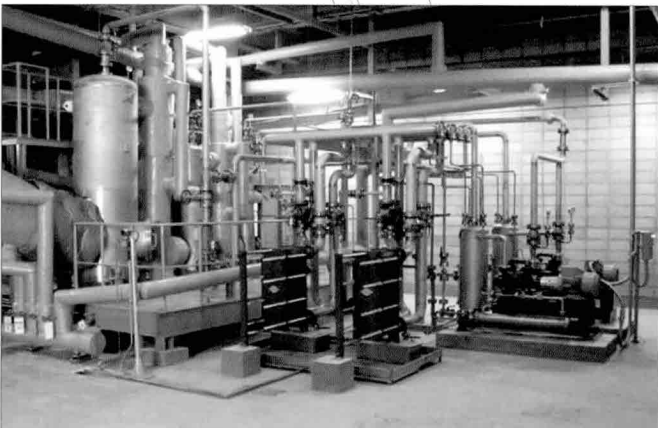
[그림 3] 이젝터 설치 전경
