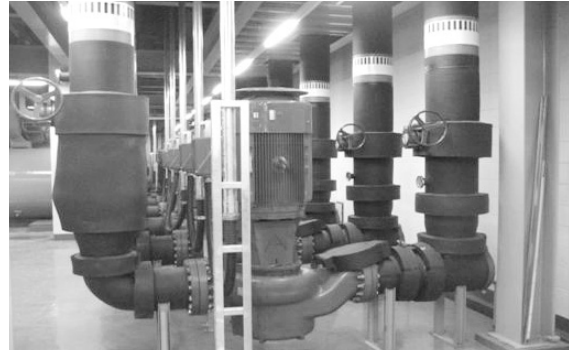
▲ 기계실 냉수펌프 배관
