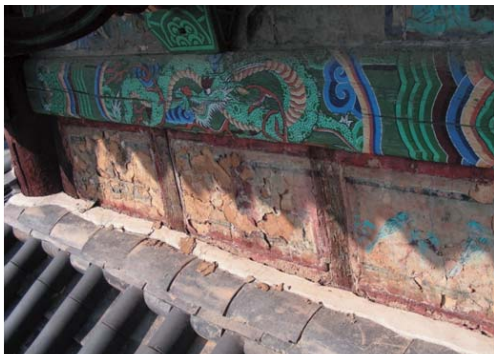
Figure 1. 금산사미륵전벽화 손상 현황
