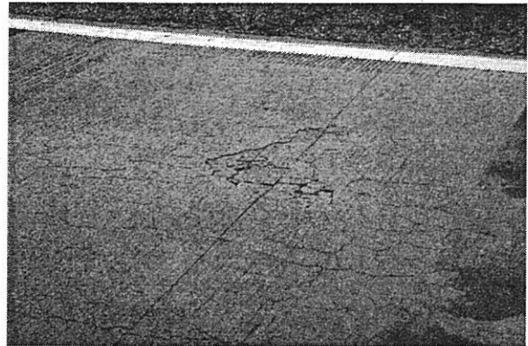
<그림 3> 알칼리골재반응 파손
