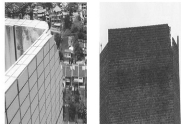
콘크리트 및 벽돌 건축물이 낙뢰에 의해 피해를 입은 예
