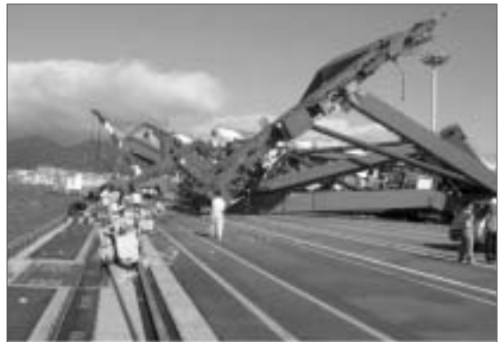
<사진 2> 크레인붕괴상황을 넘어진 방향에서 촬영한 상태
