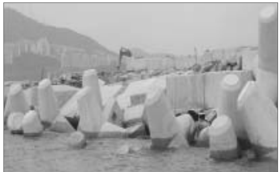
〈사진 3〉해일에 의해 블록이 유실 및 전도된 상태(신선대)
