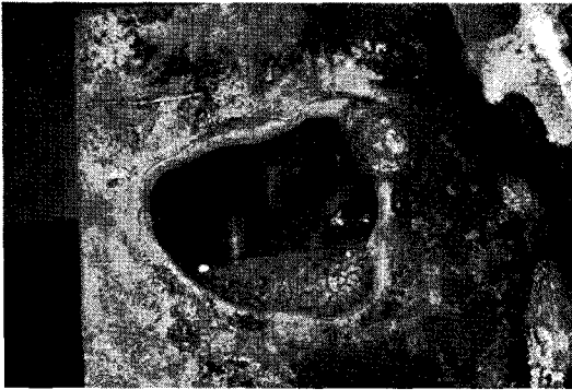
Fig. 19. 외함 용융 근접 촬영.
