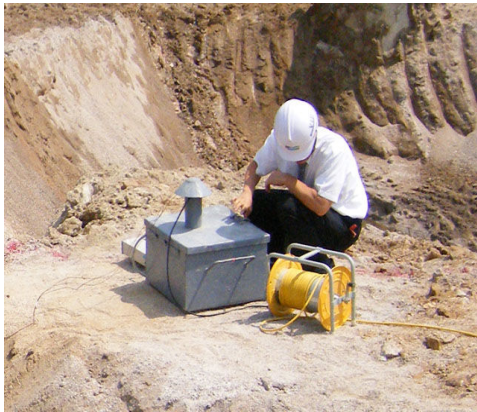
(a) 데이터로거 설치
