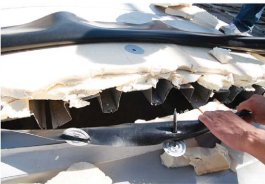
그림 10 Mock-Up Test 후 데크플레이트 파손
