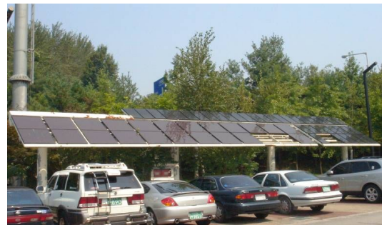
그림 2. 박막 태양전지모듈 시스템 설치 전경
