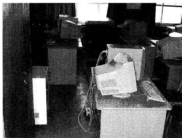
그림 2. 장비실의 미확보로 컴퓨터실에 설치된 정보통신장비
