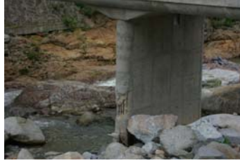
Fig. 11 임내골교 교각 파손
