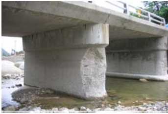
Fig. 10 큰골교 교각 파손
