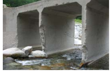
Fig. 12 무명교 교각 파손
