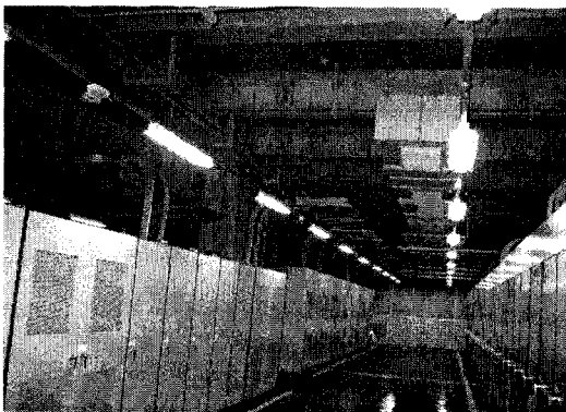
그림 1. 큐비클식 수·변전설비 Fig. 1. Cubicle type Transformer Vault
